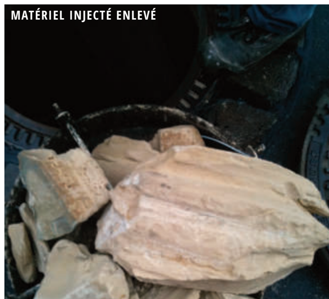
TUYAUX DE CANALISATION AVEC DU MATÉRIEL D'INJECTION
