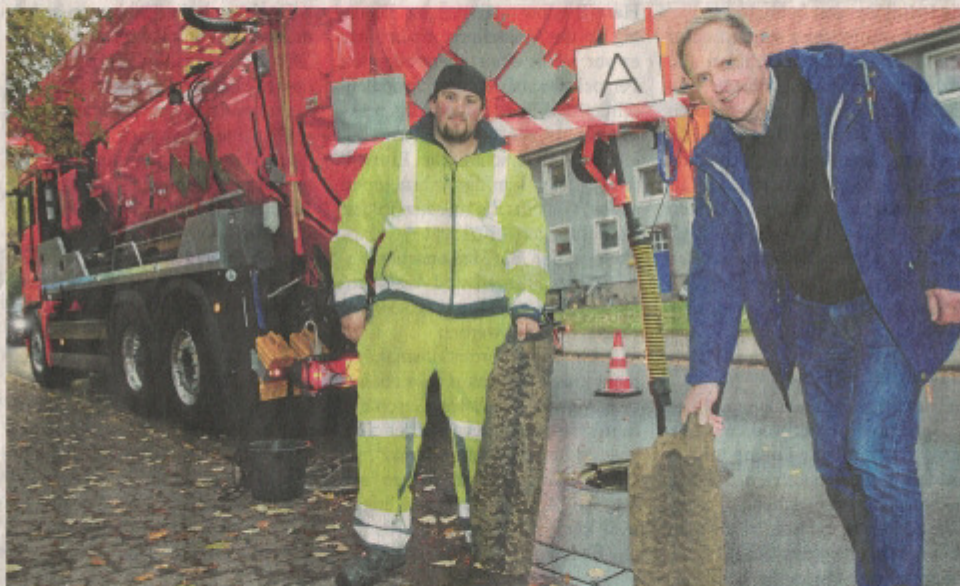
Fachdienstleiter Torsten Fleige-Lütgering und Tim Rödiger von der Fachfirma zeigen zwei herausgelöste Kalkablagungsstücke. Diese Ablagerungen verstopften den Kanal in der Erikastraße.
