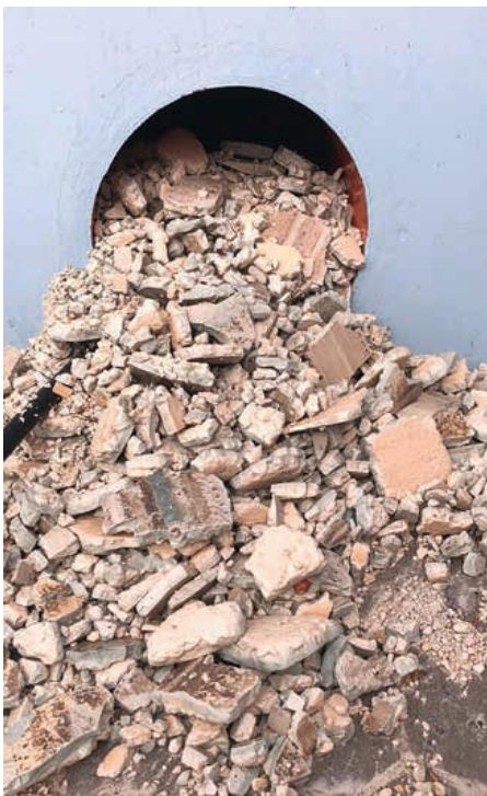
Bild 5: Zementsuspension gelangte aus Versehen während der Bauphase in die Regenfallrohe.
