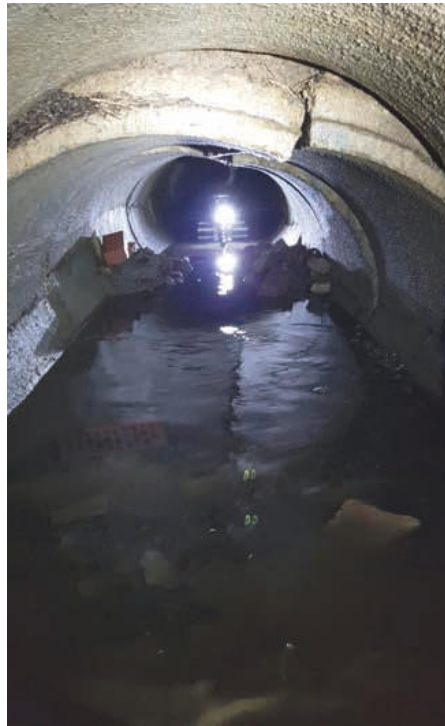
Bild 7: Der Höchstdruck-Wasserstrahl-Roboter arbeitet auch dort noch, wo sich der Fräsroboter nicht mehr hin traut.
