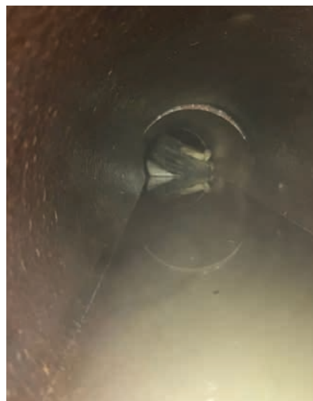
Gelöste Betonschollen im Kanal | Fotos: Mauerspecht
