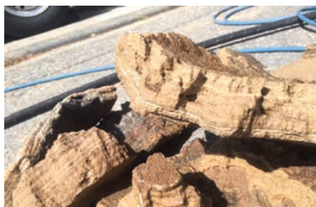
Versinterung aus Bachverrohrung, DN 600
